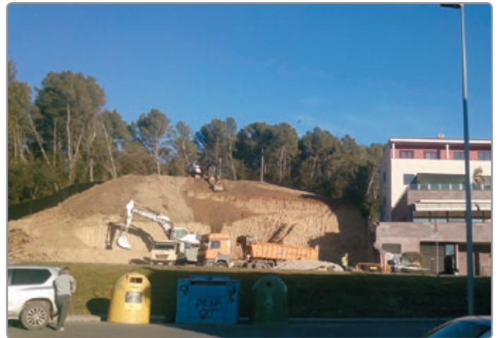
• Estat actual de les obres d'ampliació de les places del Residencial Palau.
