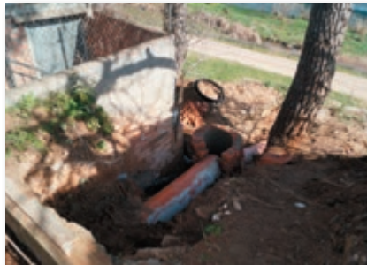
C/ Mataró (Montjuic) Arranjament clavaguera trencat
