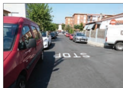
Asfaltats als C/ Sant Miquel i C/ Dom Bosco, al centre de la Vila
